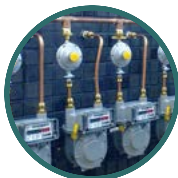
Medidor individual de energia e gás no Gourmet e Churrasqueiras.
