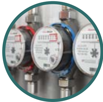
Hidrômetro e medidor de gás individual.
